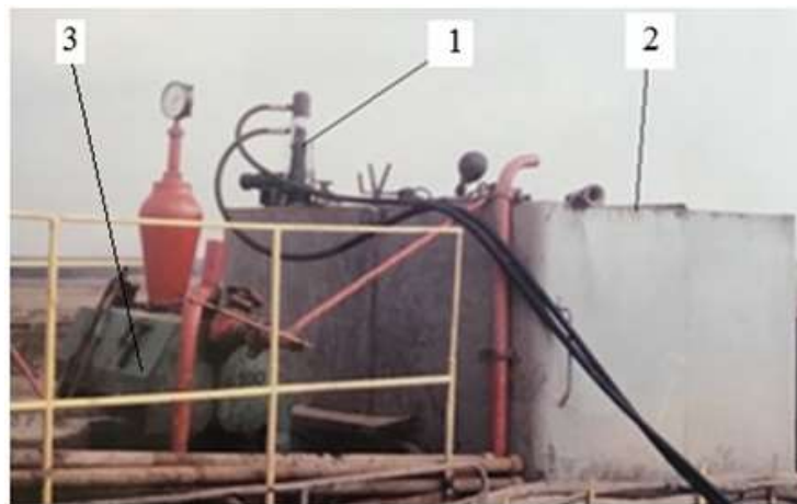
Рисунок 3 – Установка дослідного зразка ІГІ над баком робочої рідини насосного агрегату ЦА-320: 1 – ІГІ, 2 – бак насосного агрегату; 3 – насосна установка
