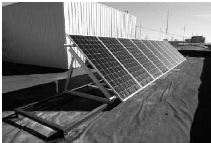
Рисунок 2 – Фотоелектричні панелі на опорних конструкціях
