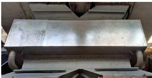
Рисунок 5 – Экономайзер, установленный за котлом ПТВМ-30м, г. Вишневое Киевской области
